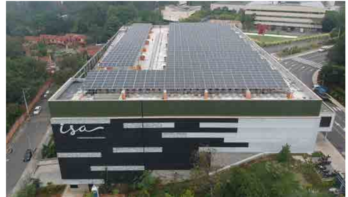
Planta solar en la sede principal en Medellín
